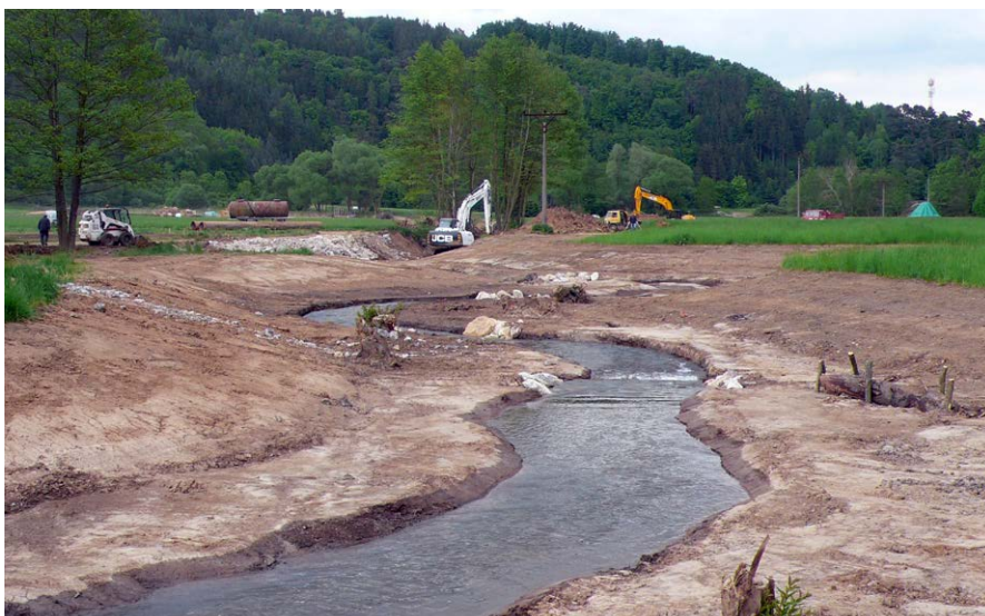
Revitalizační koryto Loděnického potoka tvoří širší povodňový průleh, v jehož dně je modelována přírodě blízká kyneta pro běžné průtoky. Foto Tomáš Just
