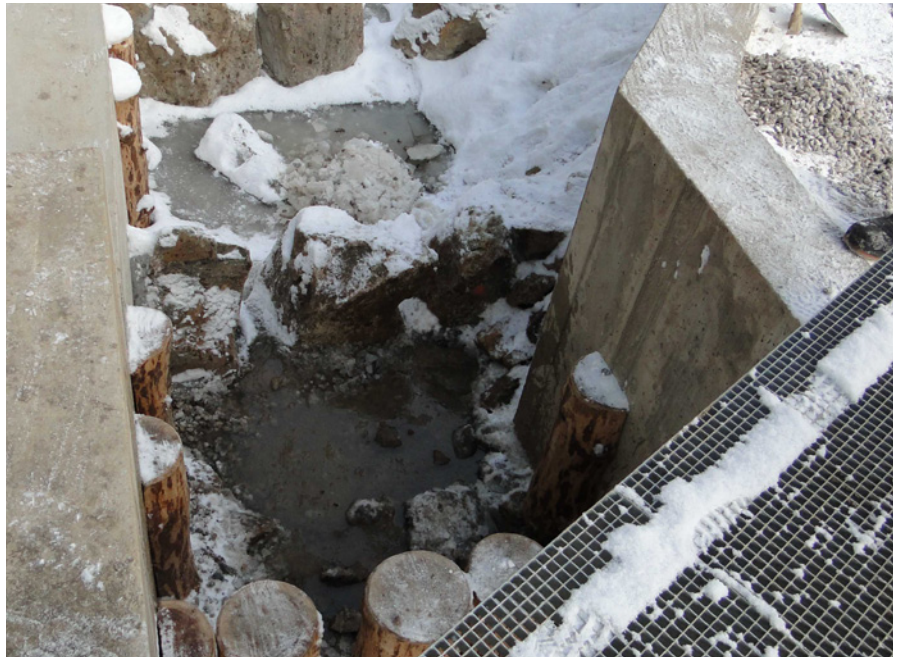
Detail vtokového objektu, rychlost proudění vody budou regulovat palisády z kulatiny. Foto Kateřina Kujanová
