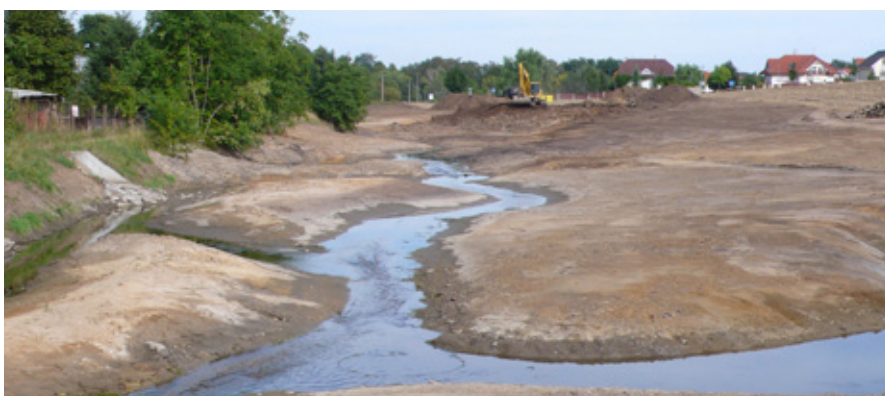
Jako poslední probíhala výstavba středního úseku revitalizace pod náměstím v Hostivicích. Rozsáhlé těžení zemin umožnilo zásadně změnit charakter potočního perimetru a vytvořit „vodní krajinu“, jakou by tu dříve nikdo nečekal. Foto Tomáš Just
