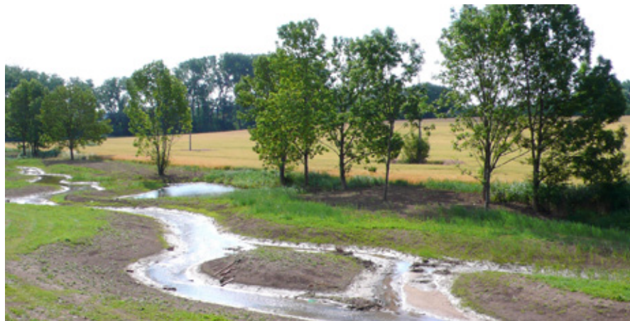
Výstavba dolního úseku revitalizace pod ČOV. V prostoru dřívějšího technicky upraveného koryta – procházelo podél řady stromů vzadu – byl vyhlouben sled biotopních tůň. Většina z nich byla v zájmu ochrany obojživelníků následně oddělena od kynety kamennými záhozy, omezujícími vstup ryb z potoka.. Foto Tomáš Just
