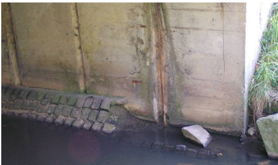
V některých případech se v propustcích „staré“ D1 nacházejí lávky pro zajištění suchého průchodu, ale chybí nebo je zničeno jejich napojení na prostředí venku, a tak jsou vlastně nefunkční. Foto Marie Brůčková
