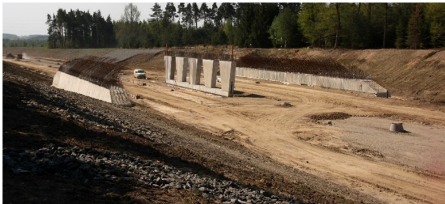
Stavba ekoduktu na dálnici D3 v úseku Veselí nad Lužnicí – Tábor. Kdo by dnes zpochybnil zkrácení a zlevnění cesty z Budějovic do Prahy, byť je cestování poněkud nudnější? Chceme snad jezdit jako před dvěma sty lety dostavňikem, s noclehem v Dobříši a s průjezdem Brdských lesů plným loupežníků?
