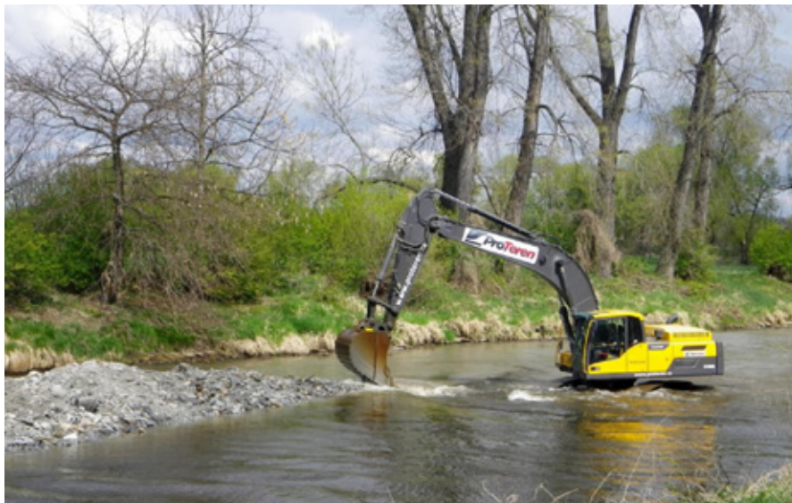
Nepovolená prohrábka v korytě Vltavy. Foto Irena Berecová, ČIŽP
